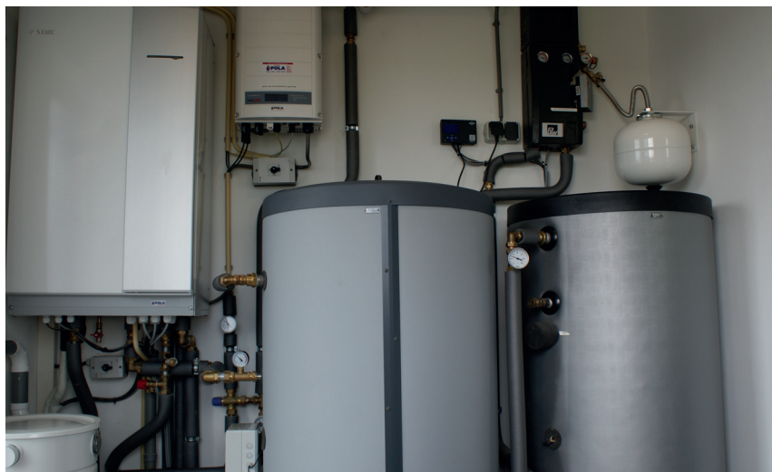
△ Technische ruimte met warmtepomp en voorraadvaten voor verwarming en tapwater. De watertemperatuur wordt niet hoger dan 85 graden. Dat is ruim voldoende.
